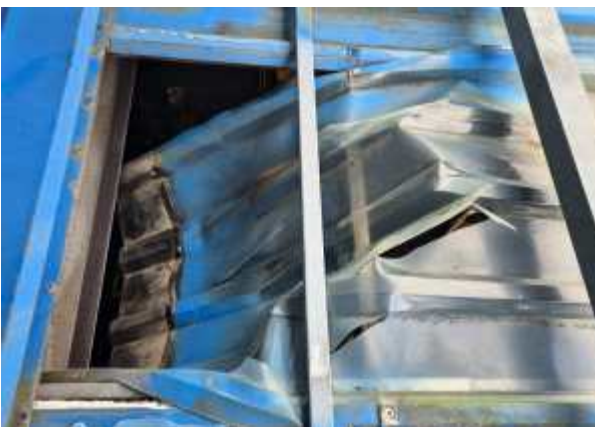
[사진7] 재해자 추락지점(지붕 위)
