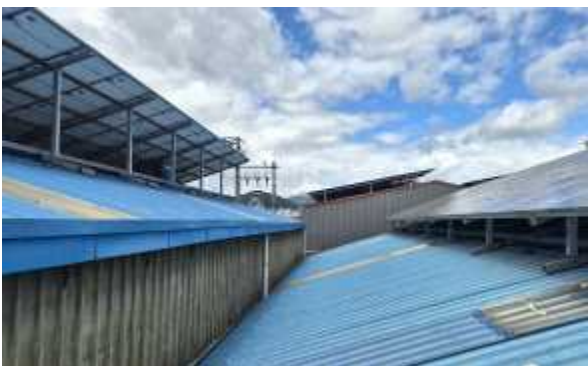
[사진11] 지붕 위 안전난간 미설치
