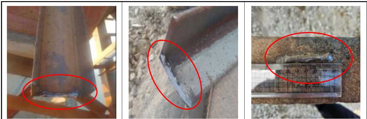
【사진13, 사진14, 사진15】 파단 된 컨베이어 하부 프레임 지지부재(L-형강) 용접 흔적
