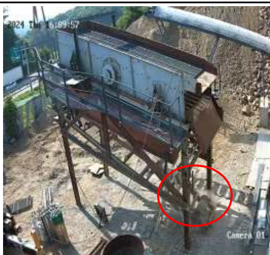
【사진9】 컨베이어 하부 프레임 용접부위 탈락
