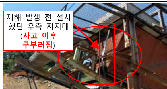
【사진8】 재해자 작업위치 및 지지대 고정 사진
