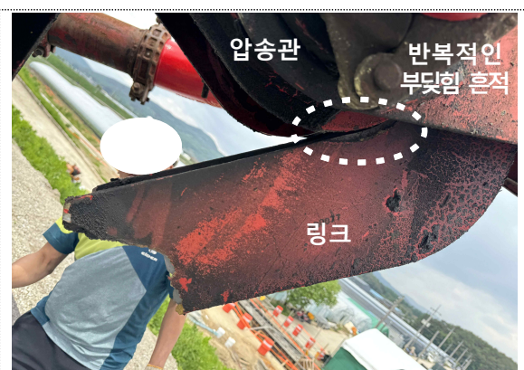
【사진15】 압송관 주변 용접부 균열
