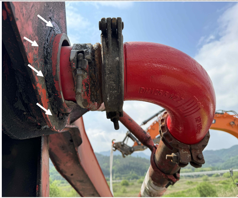
【사진16】 압송관 주변 용접부 균열
