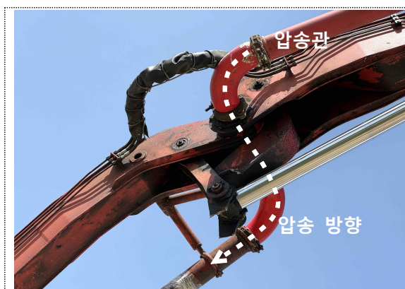
【사진14】 콘크리트 압송관
