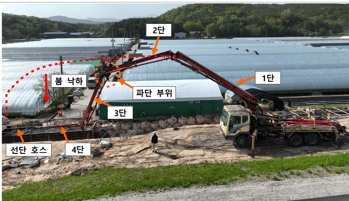
【사진4】 펌프카 붐대 파단 및 낙하 형태
