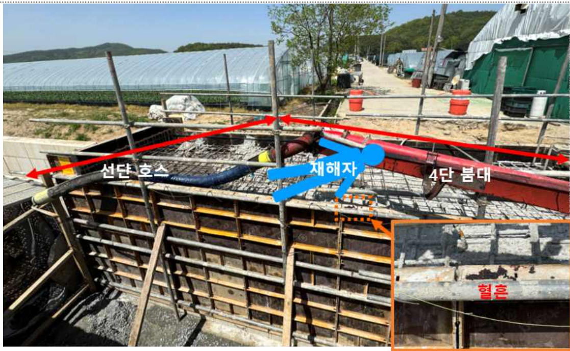
【사진3】 붐대에 맞은 후 재해자의 위치(추정)
