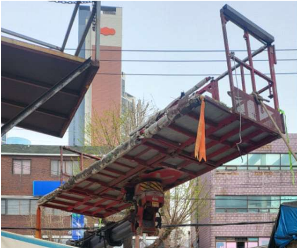
[사진 4] 사고 당시 작업대 전면 안전난간 누락된 상태
