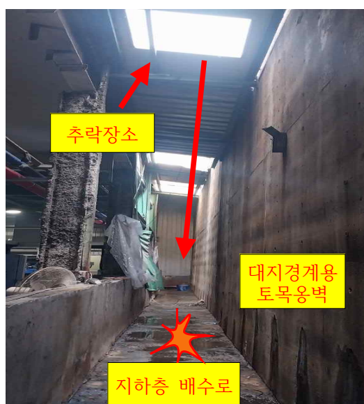
사고지점 하부(지하층 배수로)
