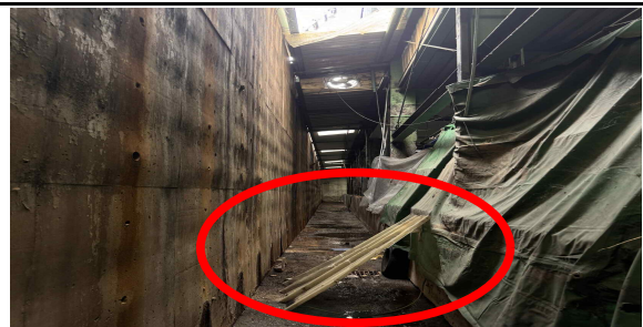
지하층 배수로에 떨어진 탈락 채광창
