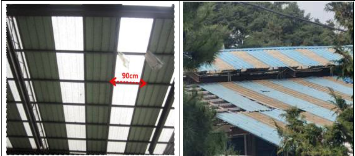
지붕 위 작업 중 떨어짐 방지 미조치 상태
