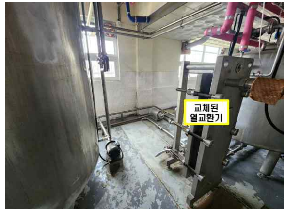
[사진2] 열교환기 교체작업장소(사고발생위치)
