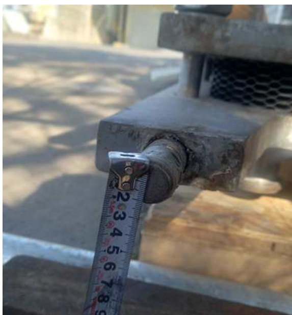
[사진5] 열교환기 지지대(하단부 모습)
