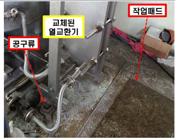
[사진11] 작업당시 작업장 바닥(사업주 제공사진)
