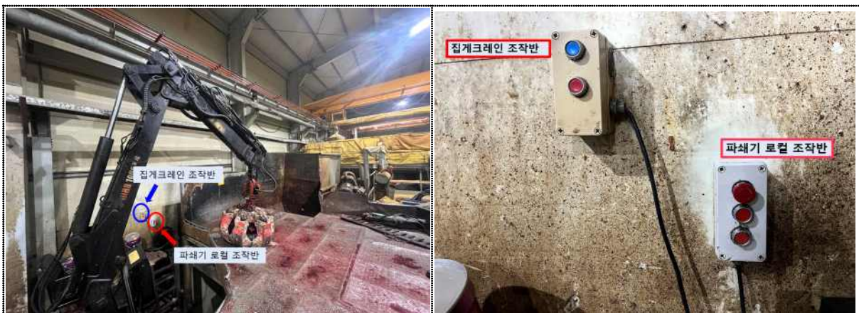
집게크레인 및 파쇄기 조작반 설치상태
