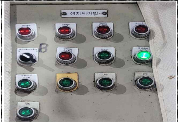
제어반 전원투입 상태 (재해당일 초동조사 사진)
