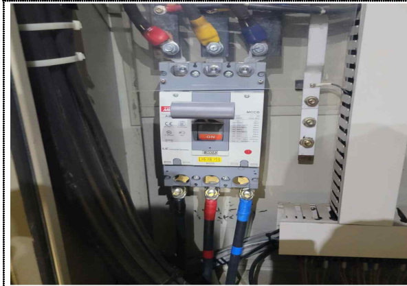
파쇄기 차단기 미차단 (재해당일 초동조사 사진)
