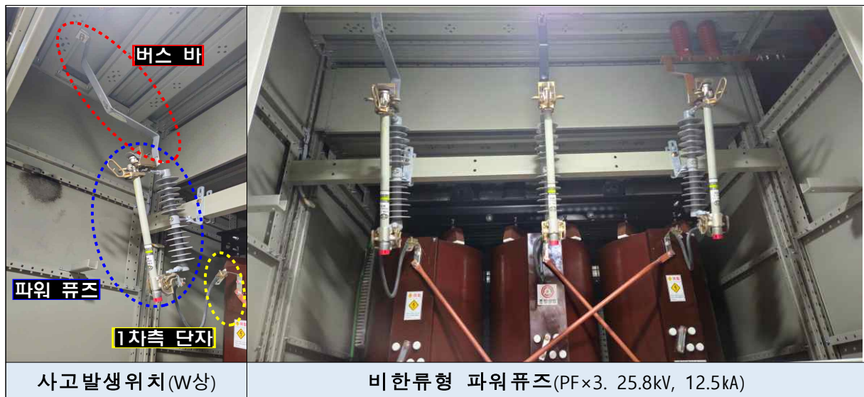
[사진 1] 몰드변압기 1차측 단선형태
