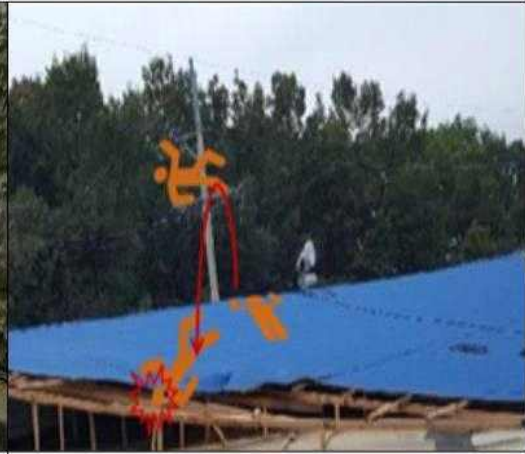
[사진2] '19. 9. (경기 파주) 지붕 보수 중 떨어짐
